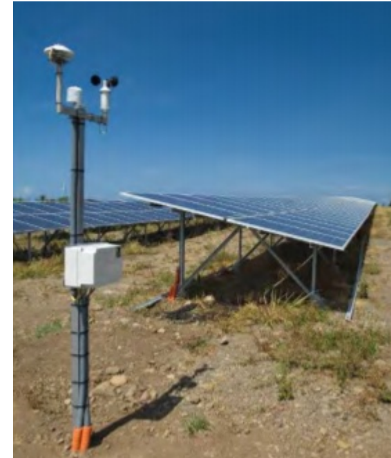
Station météo (Source : centrale Le Syndicat, Ile de la Réunion, 2010)
