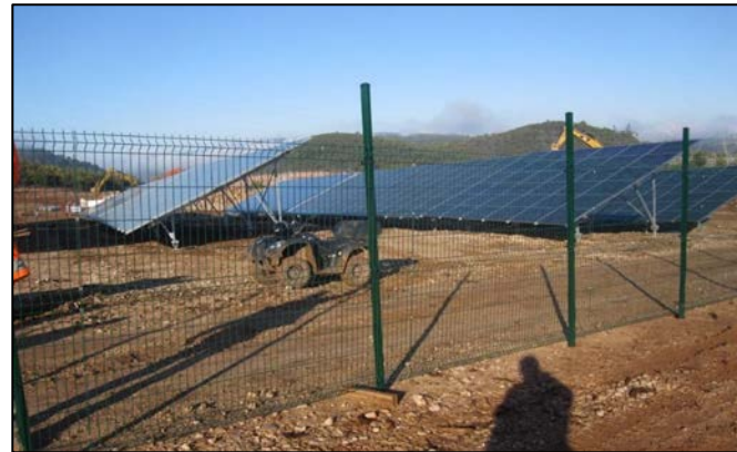
Exemple de clôture (Source : Akuo)
